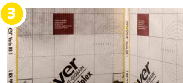
3 De verschillende banen van de Vario KM Triplex dienen elkaar ruimschoots te overlappen (minstens 15 cm). Daar waar de Vario KM Triplex vastgeniet werd of waar twee banen mekaar overlappen, wordt er vervolgens de eenzijdige kleefband, Vario KB1 , geplaatst zodat de luchtdichtheid verzekerd wordt.
